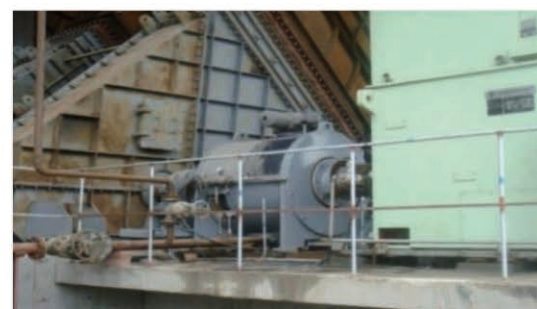
锅炉引风机配套磁悬浮调速器
