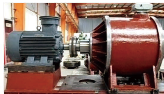
1400KW磁悬浮调速器测试中
