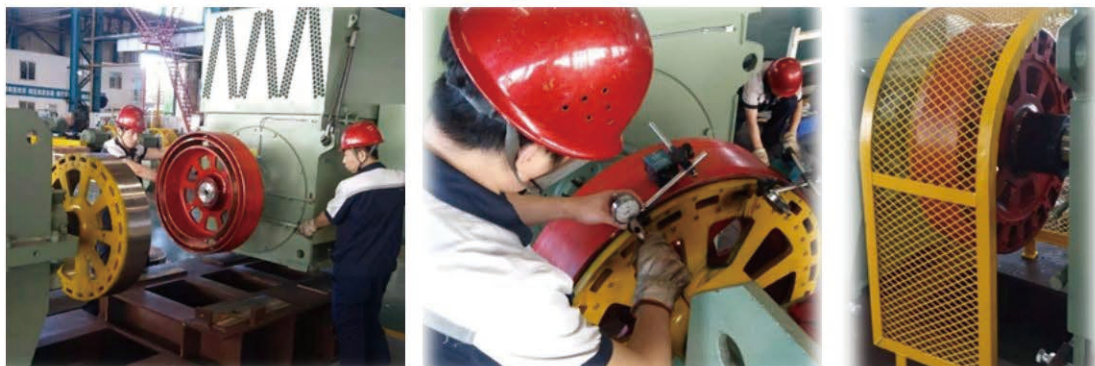
宝钢湛江码头 EMSS系列磁悬浮节能软启动器安装
